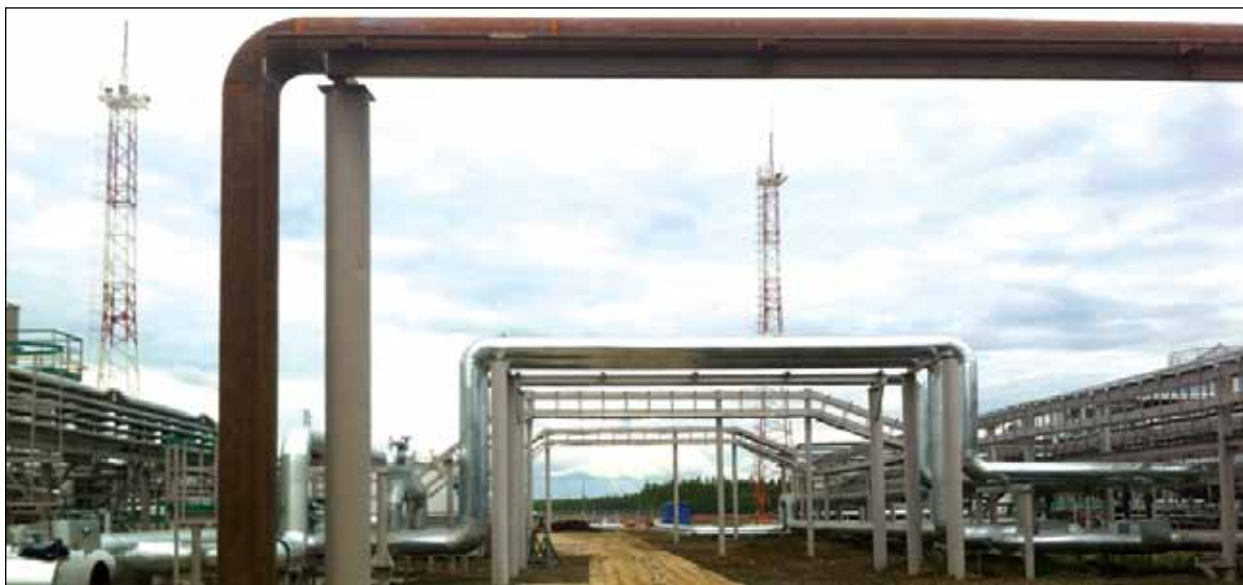
БКНС-2. Трубопроводы к площадке огневых подогревателей
